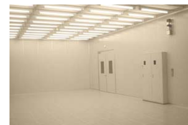
<クリーンルーム>
